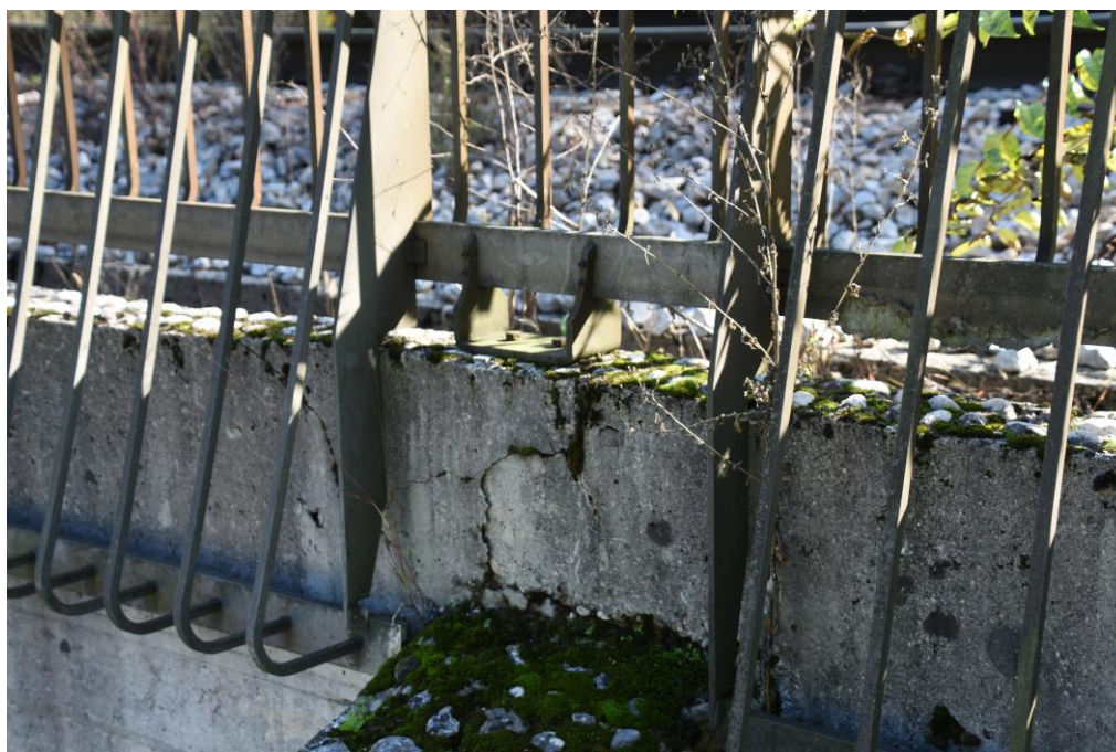
Slika 3: Parapeti na hodniku - razpoka
