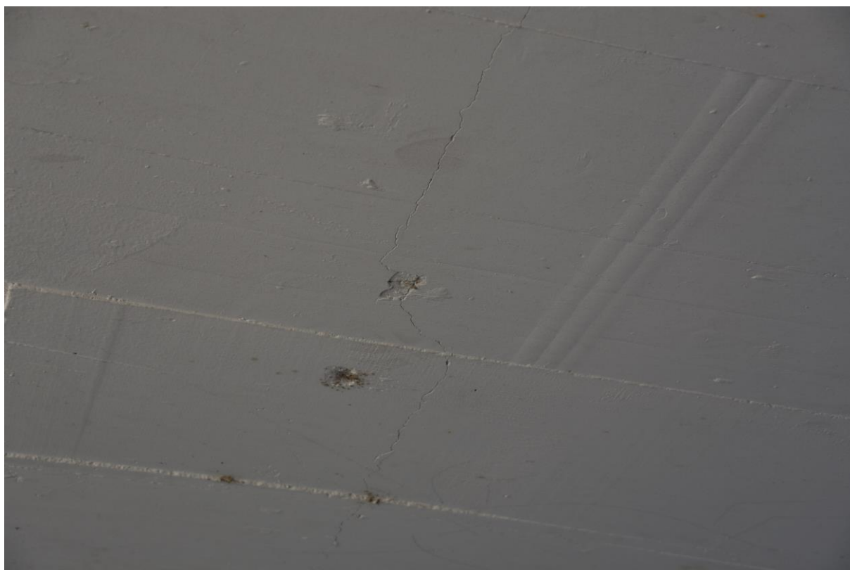
Slika 2: Razpoke na voziščni plošči
