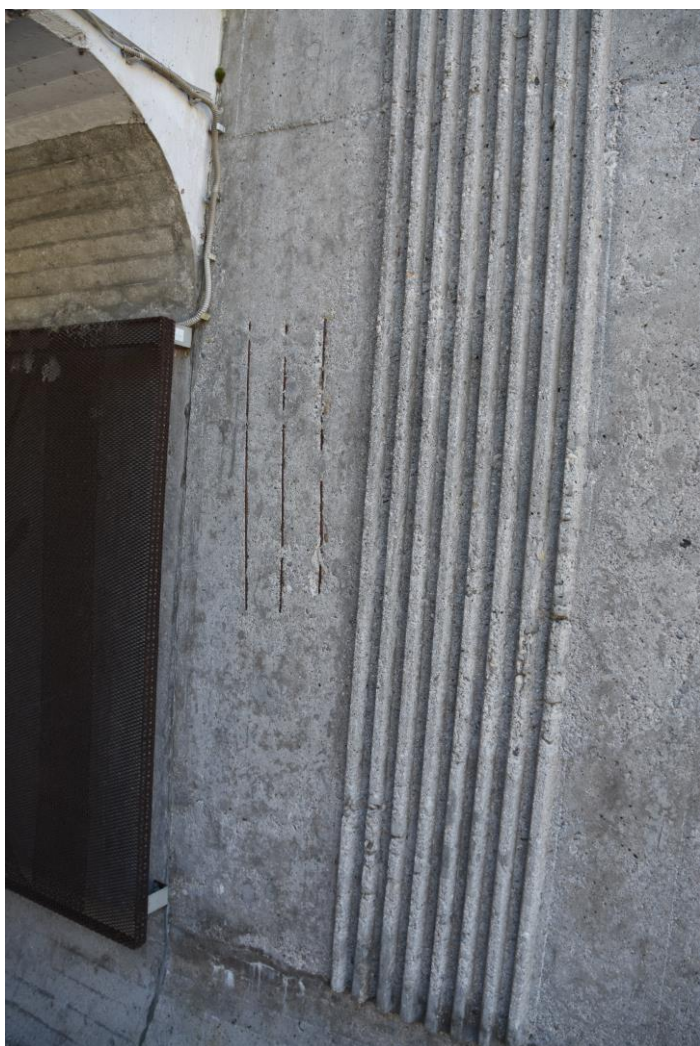
Slika 5: Stena pristopne rampe – vidna armatura
